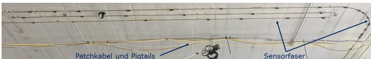
Abb. 1. Sensorapplikation an der Unterseite der Betonbrücke 705.
